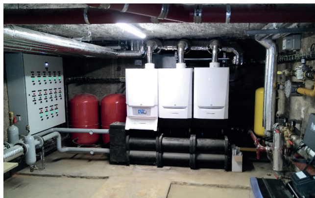
Fayl-Billot 52500 - Chaudières gaz De Dietrich en cascade
