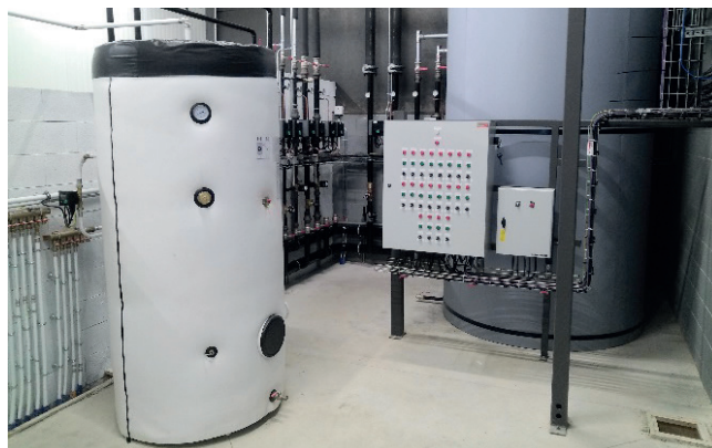
Rivières-les-Fosses 52190 - Panoplie de chaufferie et ballon tampon de 6 000 L
