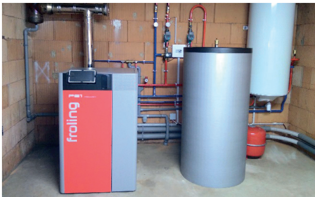
Flagey 52250 - Chaudière Froling granulés de bois
